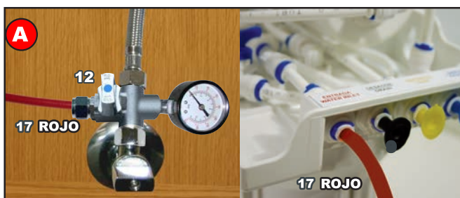
TOMA DE AGUA FRÍA ⇒ ENTRADA DE AGUA AL EQUIPO
